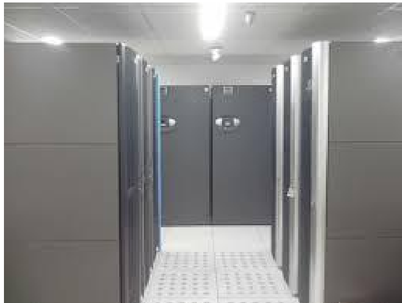
Figuram 07 - Data Center instalado nas dependência do prédio do CTIC
