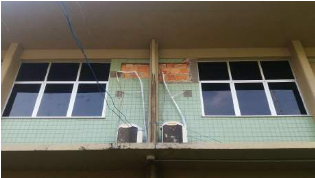
Figura 4: Trechos com ausência de revestimento
