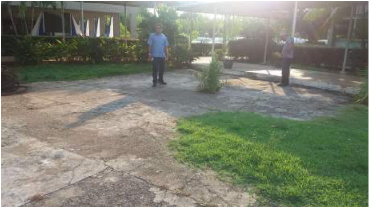
Figura 18: Área com acúmulo de águas pluviais
