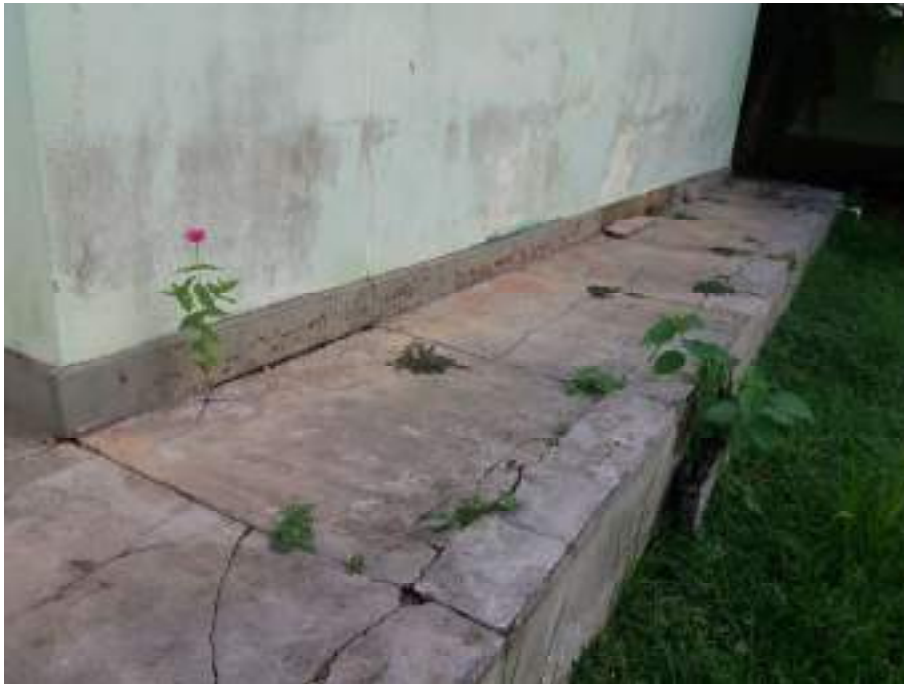
Figura 11: Meio-fio Bloco B
