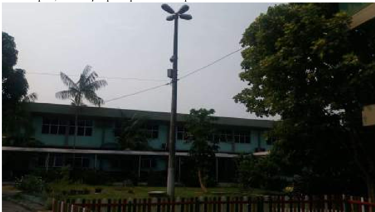
Figura 16: Poste de iluminação- Lâmpadas avariadas
